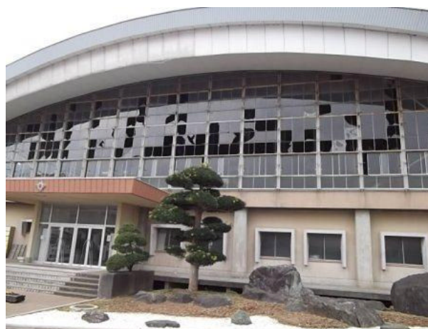
体育館の窓ガラスの破損
