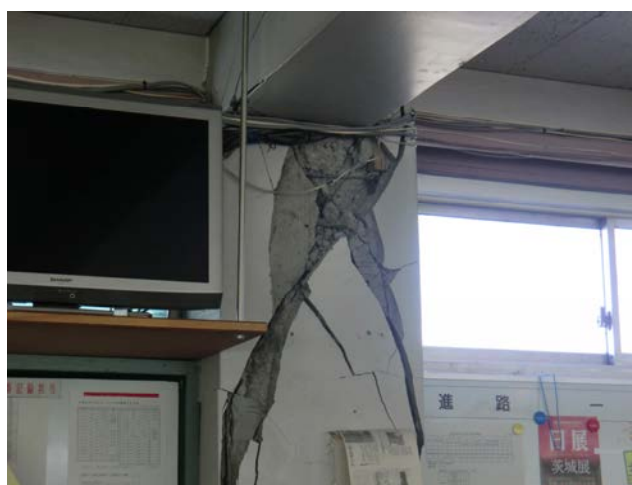
教室の柱の破損
