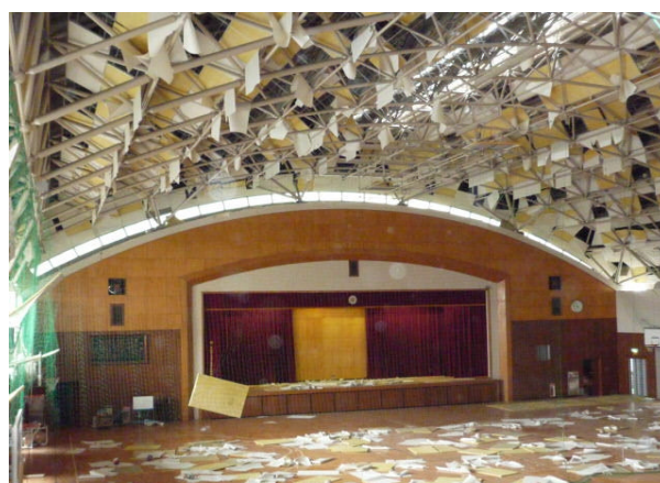
体育館天井の破損
